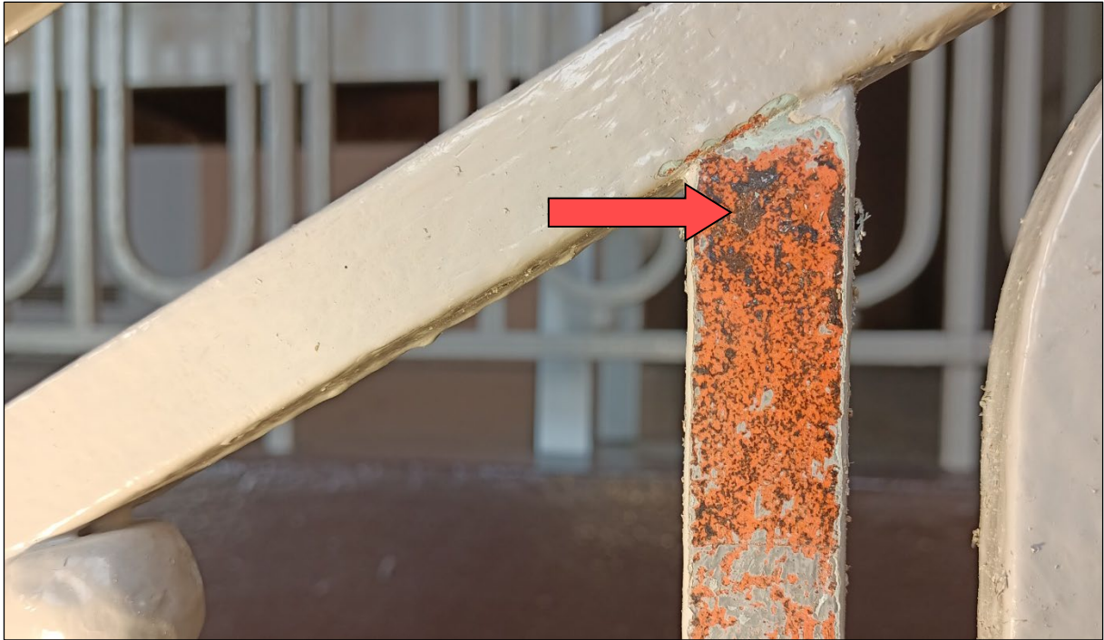
Il. 41. Metaloplastyka balustrady schodów. Pod wtórnym podkładem antykorozyjnym widoczna ciemnoszara, naturalna powierzchnia metalu.
