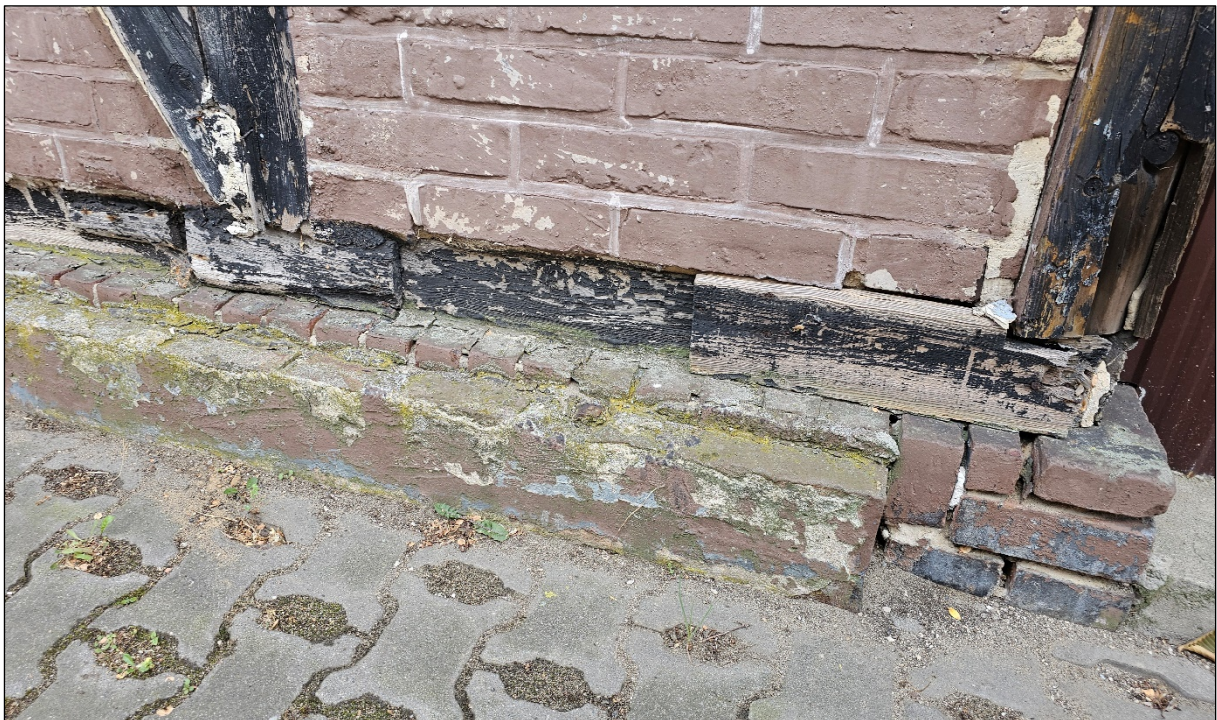
Il. 25. Podwalina w zachodnim narożniku elewacji północnej. Sztukowana przynajmniej kilkukrotnie. Dolne partie słupów przegniłe.
