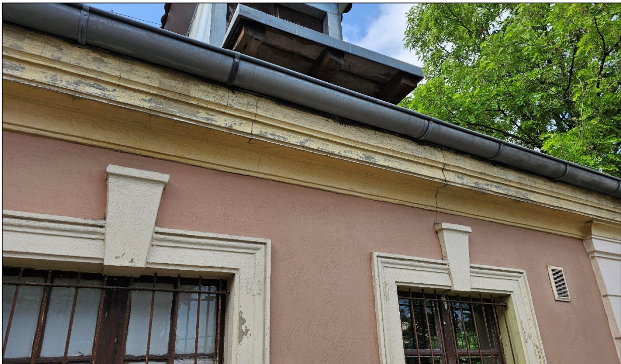
Fot. 35. Budynek dawnej zwierzętarni. Pęknięcia statyczne w górnych partiach elewacji północnej.
