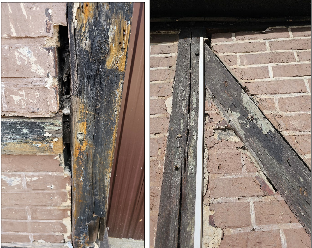
Il. 27. i 28. Stan zachowania elementów drewnianych konstrukcji ryglowej w elewacji południowej.
