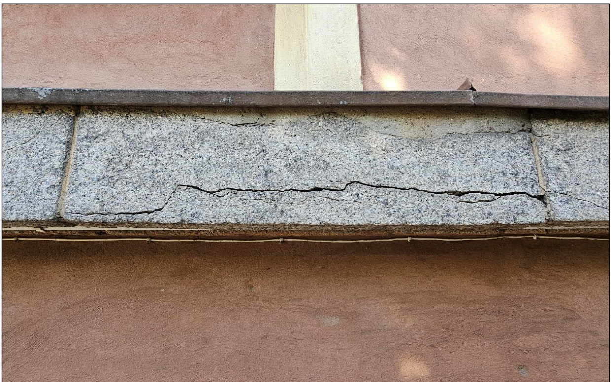
Il. 14. Uszkodzony blok granitowy gzymsu międzykondygnacyjnego w elewacji frontowej.
