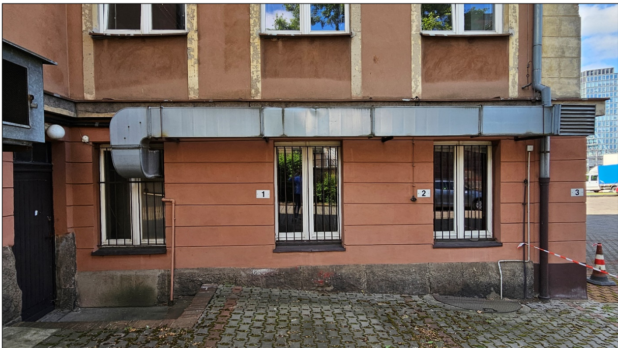
Il. 12. Instalacje techniczne na elewacji północnej. Nawierzchnia z kostki betonowej doprowadzona do ścian budynku.
