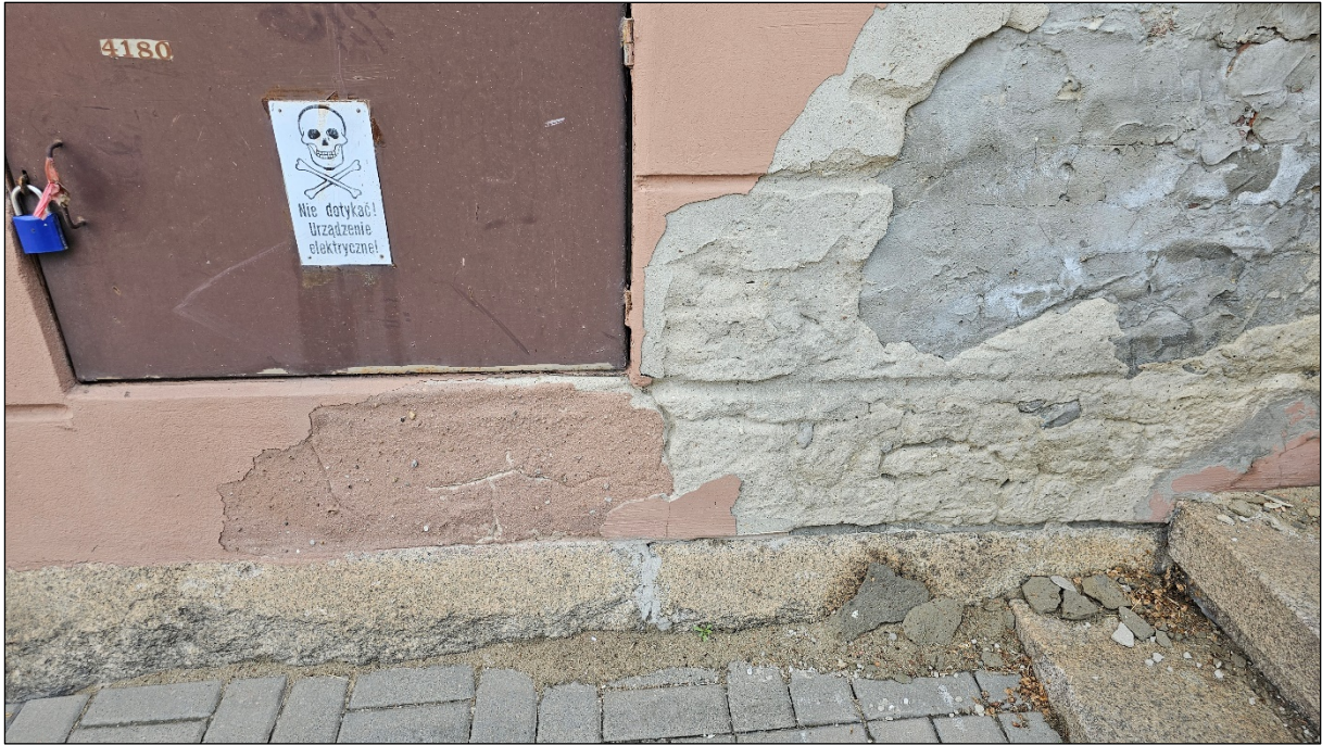
Il. 33. Uszkodzone na skutek zawilgocenia tynki w przyziemiu elewacji południowej.
