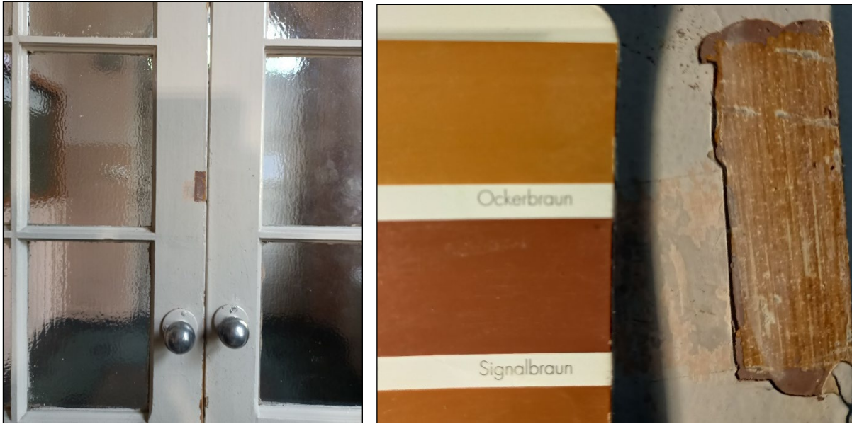
Il. 37. i 38. Drzwi wahadłowe w przedsionku wejściowym – malowane wielokrotnie farbami białymi. Na fotografii widoczna warstwa wtórna lazury orzechowej.
