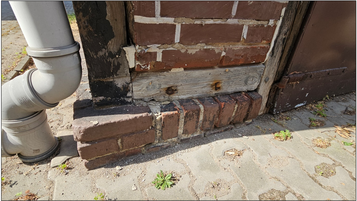
Il. 26. Podwalina i słup we wschodnim narożniku elewacji północnej. Wypełnienie ceglane widoczne powyżej wypada na zewnątrz konstrukcji.
