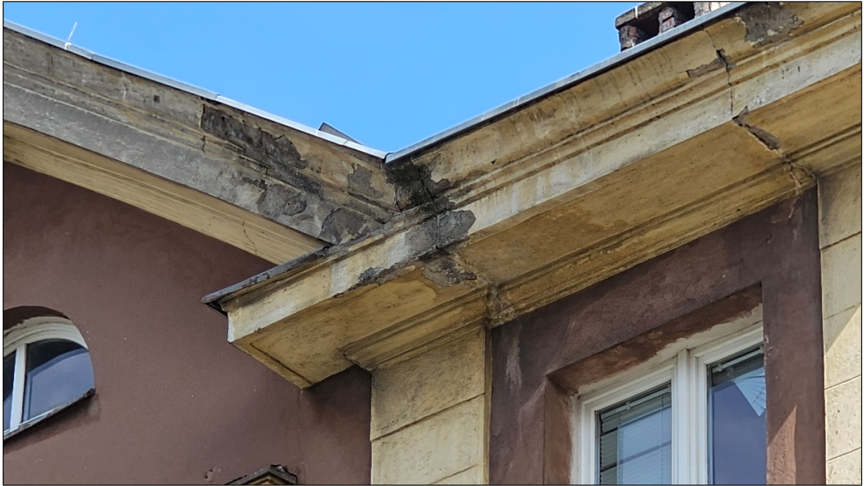
Il. 17. Uszkodzenia gzymsów spowodowane wieloletnim zamakaniem w elewacji tylnej – zachodniej.
