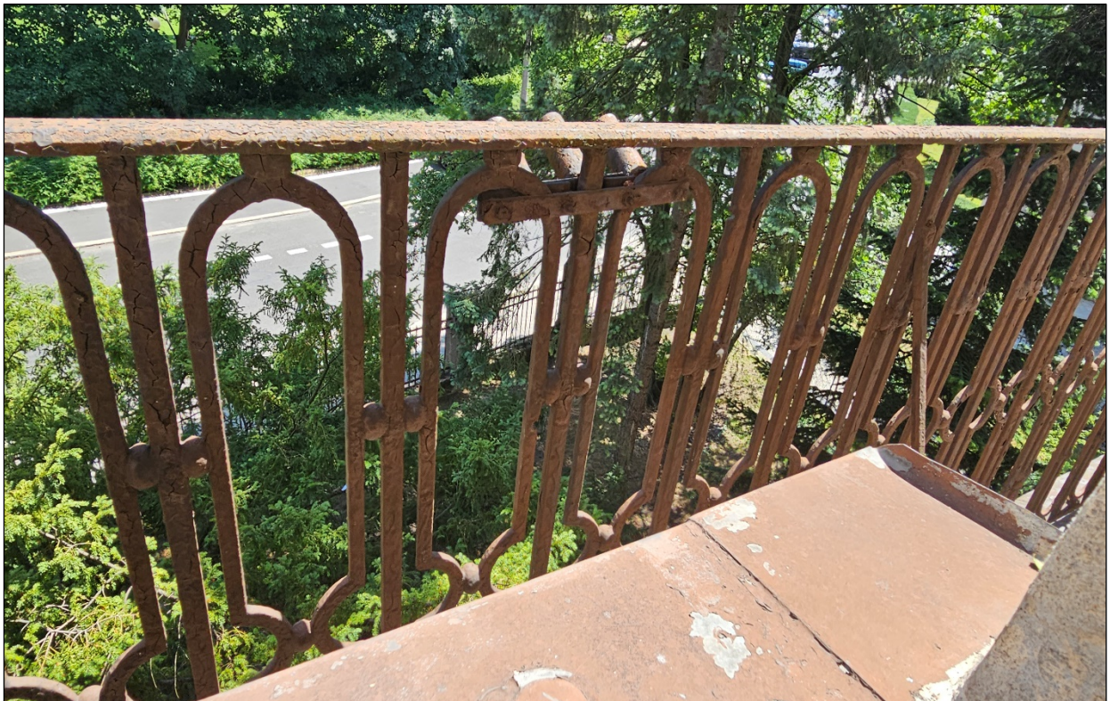
Il. 18. Skorodowana balustrada na osi piętra elewacji frontowej.
