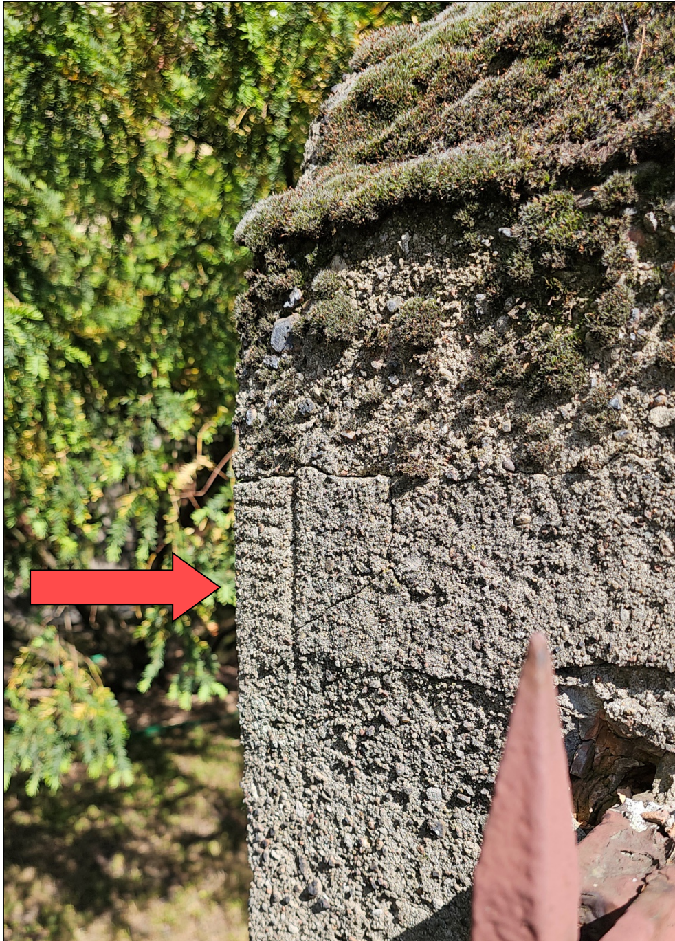
Il. 8. Porośnięty mchem słup ogrodzenia. Strzałką wskazano pozostałości dekoracyjnego opracowania krawędzi.
