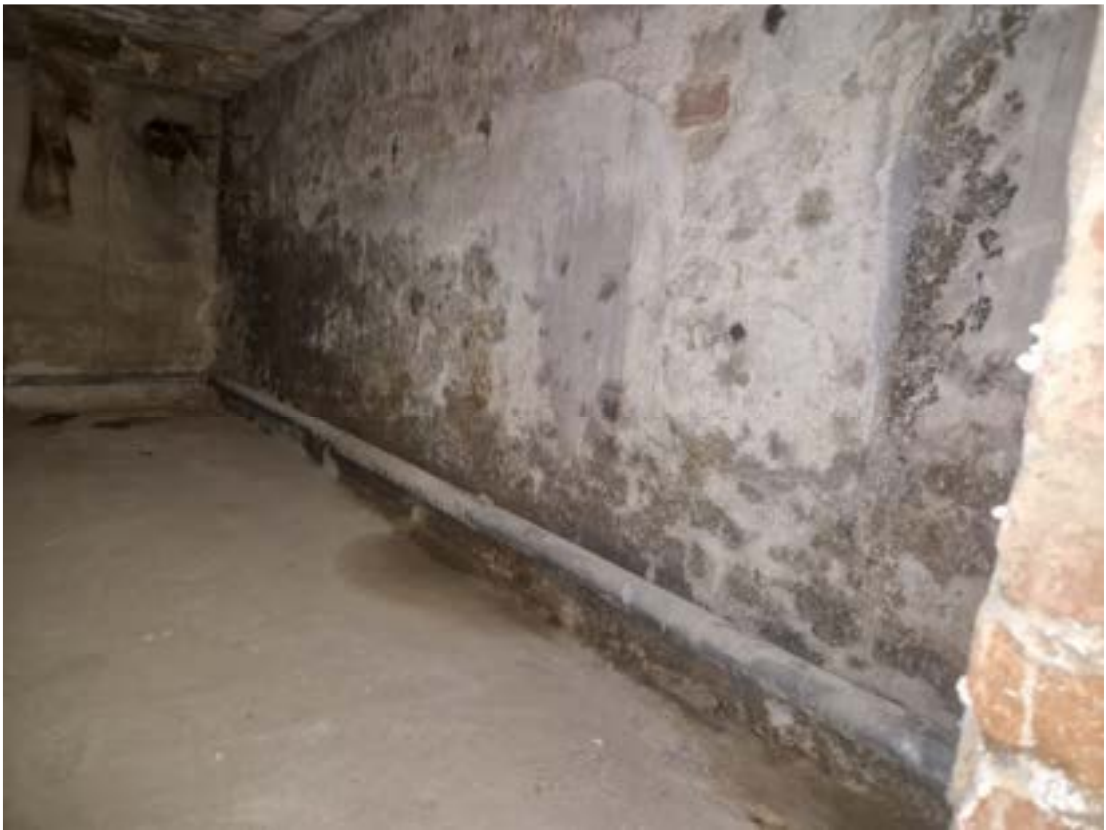
Fot. 14. Pomieszczenie w podpiwniczeniu fragmentu ryzalitu (od strony południowo-zachodniej – prawdopodobnie dawny skład opału lub kotłownia) – silne zawilgocenia, odspojenia tynków i oznaki rozwoju korozji
