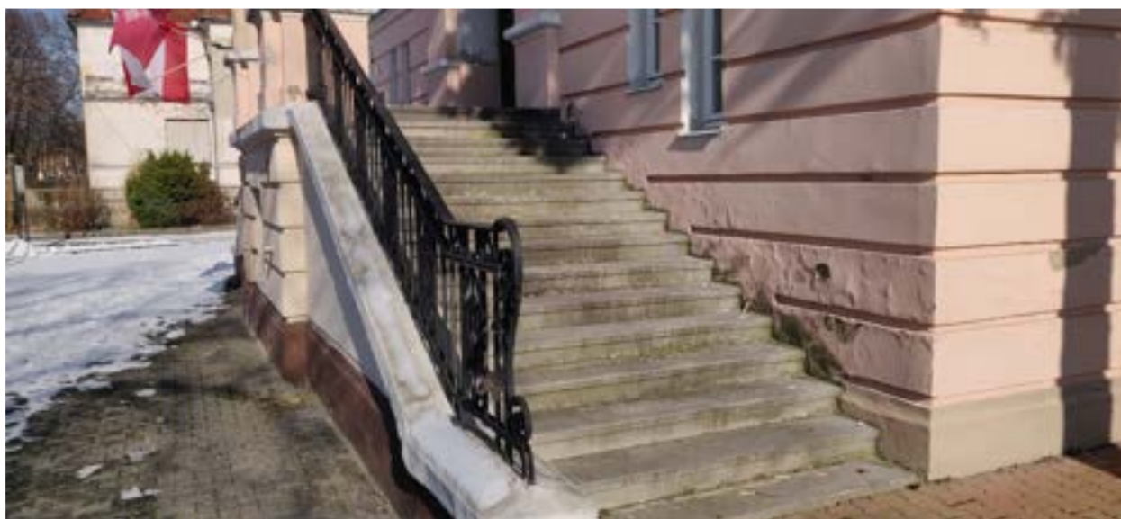
Fot. 1. Elewacja frontowa (zachodnia), fragment ryzalitu ze schodami wejściowymi – silnie zawilgocona dolna partia murów widoczna w postaci ciemnych plam i odspojień wypraw tynkarskich; w części uszkodzone stopnie schodowe
