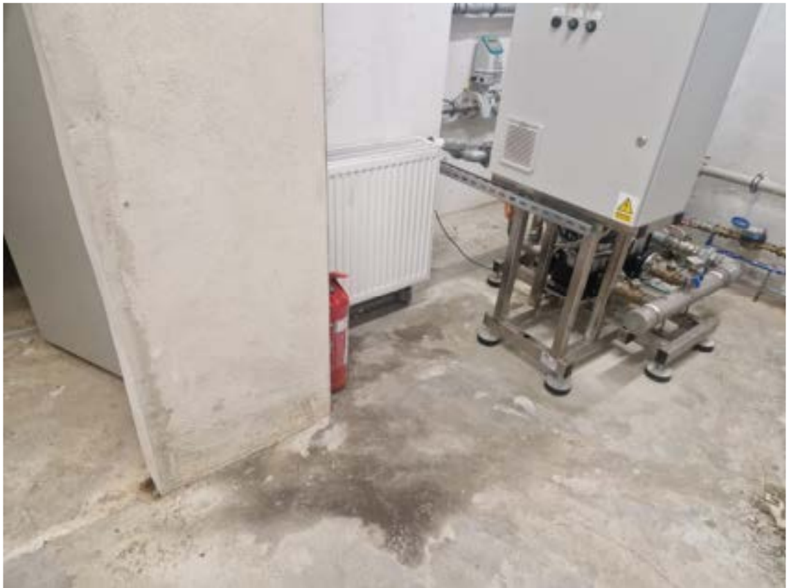
Fot. 17. Pomieszczenie w podpiwniczeniu pod frontowymi schodami wejściowymi (od strony południowej) – silne zawilgocenia, odspojenia tynków i posadzki
