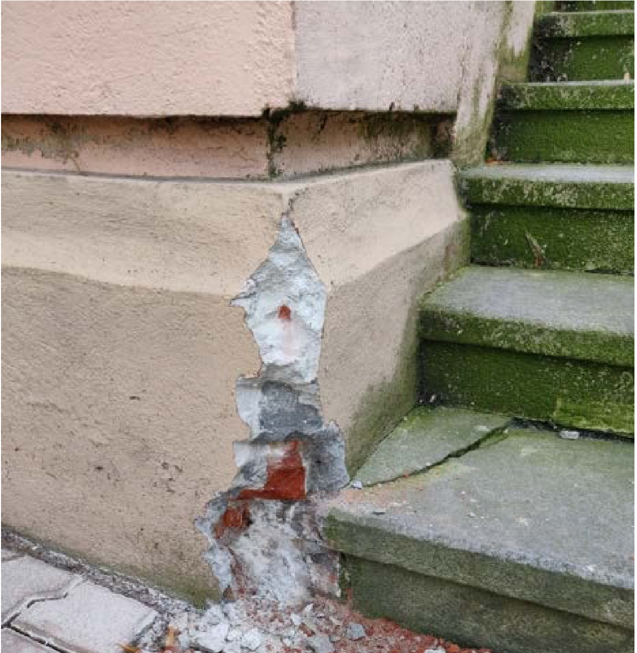
Fot. 25. Sposób osadzenia stopni granitowych w murze ryzalitu – na sztywno, na mocnej zaprawie cementowej (widoczny dużo ciemniejszy jej kolor)
