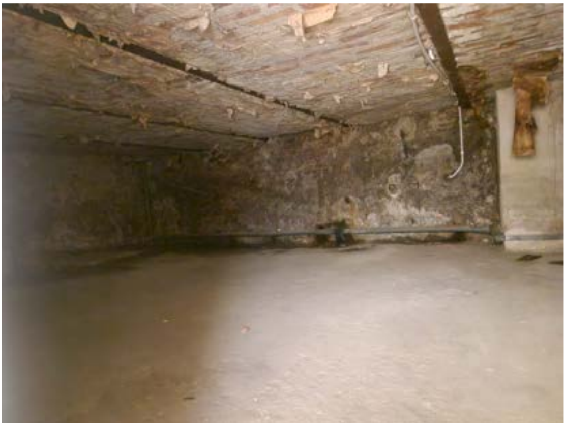
Fot. 15. Pomieszczenie w podpiwniczeniu fragmentu ryzalitu (od strony południowo-zachodniej – prawdopodobnie dawny skład opału lub kotłownia) – silne zawilgocenia, odspojenia tynków i oznaki rozwoju korozji; niestarannie i ze znacznymi nierównościami wykonany wtórny strop typu Kleina
