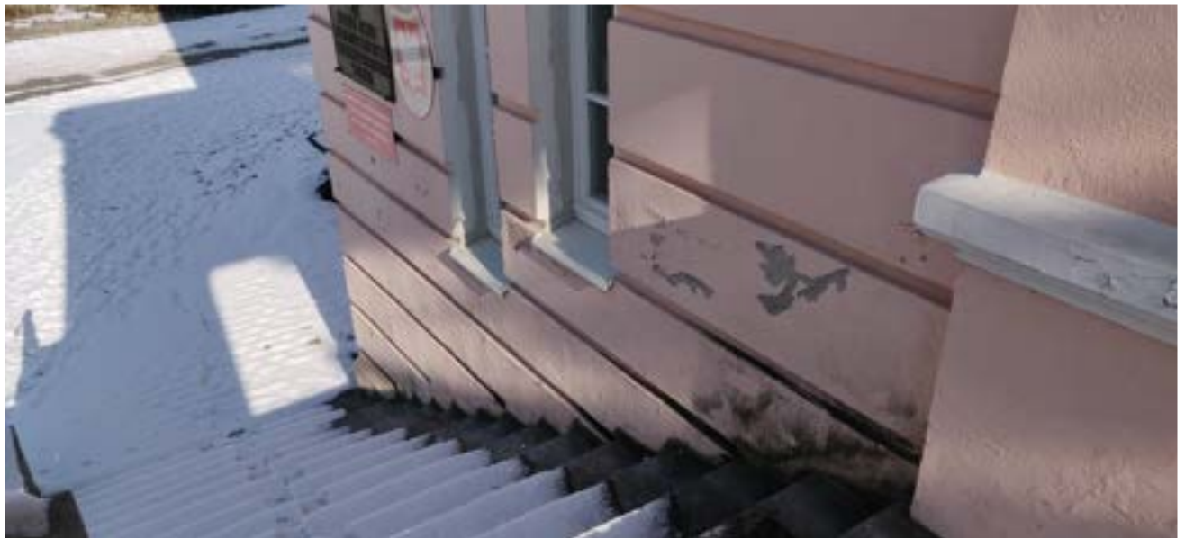
Fot. 3. Elewacja frontowa (zachodnia), fragment ryzalitu ze schodami wejściowymi (bieg północny) – silnie zawilgocona dolna partia murów widoczna w postaci ciemnych plam i odspojień wypraw tynkarskich
