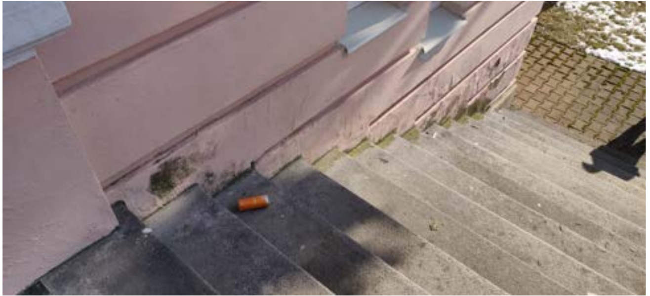
Fot. 2. Elewacja frontowa (zachodnia), fragment ryzalitu ze schodami wejściowymi (bieg południowy) – silnie zawilgocona dolna partia murów widoczna w postaci ciemnych plam i odspojień wypraw tynkarskich
