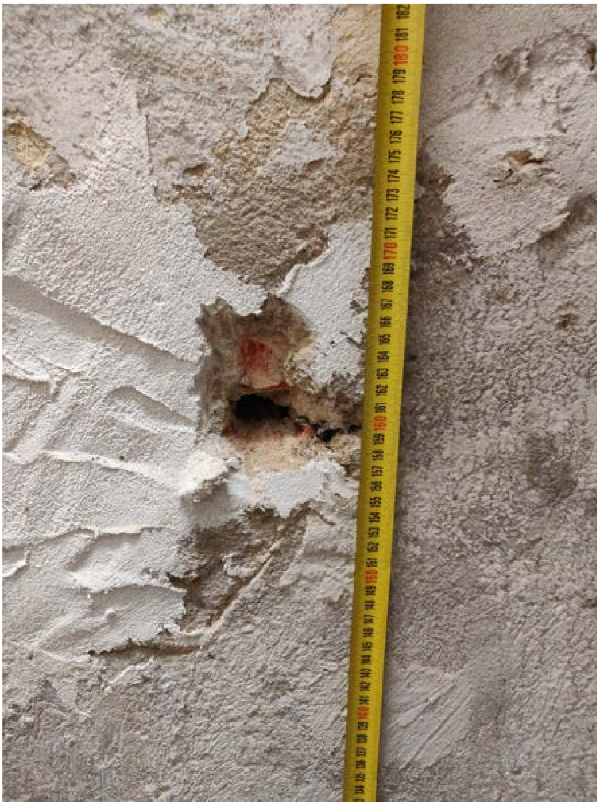
Fot. 35. Ściana wewnętrzna między częścią podpiwniczoną a pomieszczeniem świetlicowym na parterze, fragment widoczny od części podpiwniczonej ze schodów wewnętrznych – pod tynkiem w murze ceglany zainwentaryzowano poziomą izolację przeciwwilgociową bitumiczną
