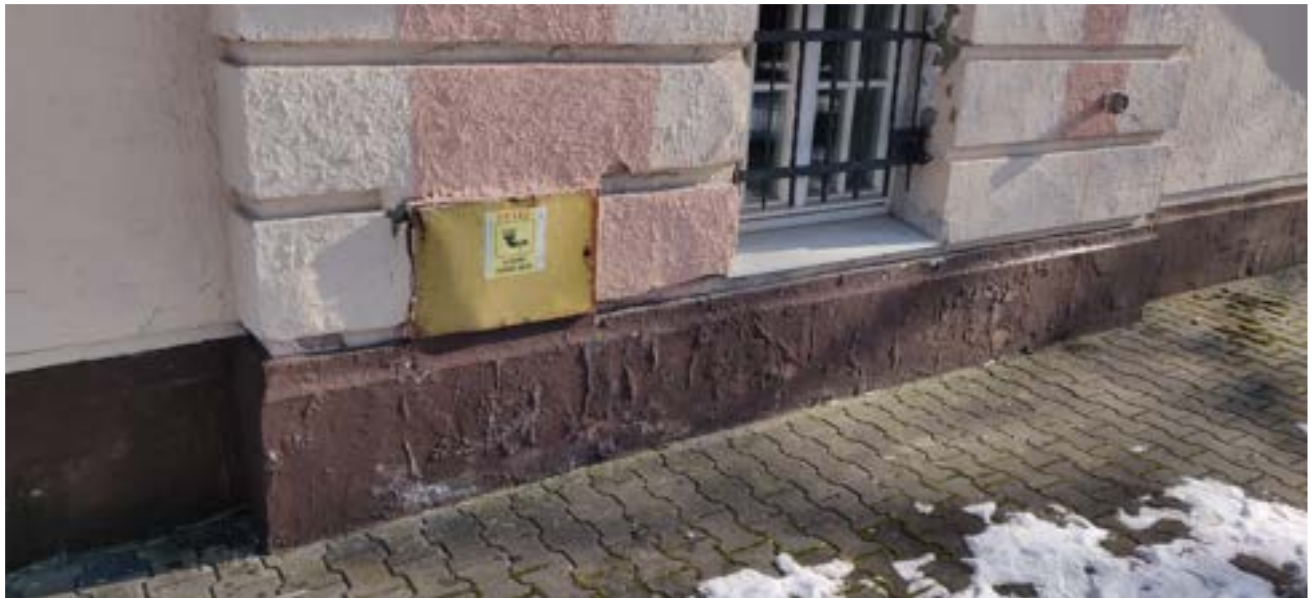
Fot. 5. Elewacja frontowa (zachodnia), fragment muru części podpiwniczonej pod spocznikiem schodów wejściowych – wyraźne odspojenie tynku; mocno zawilgocona cała partia murów
