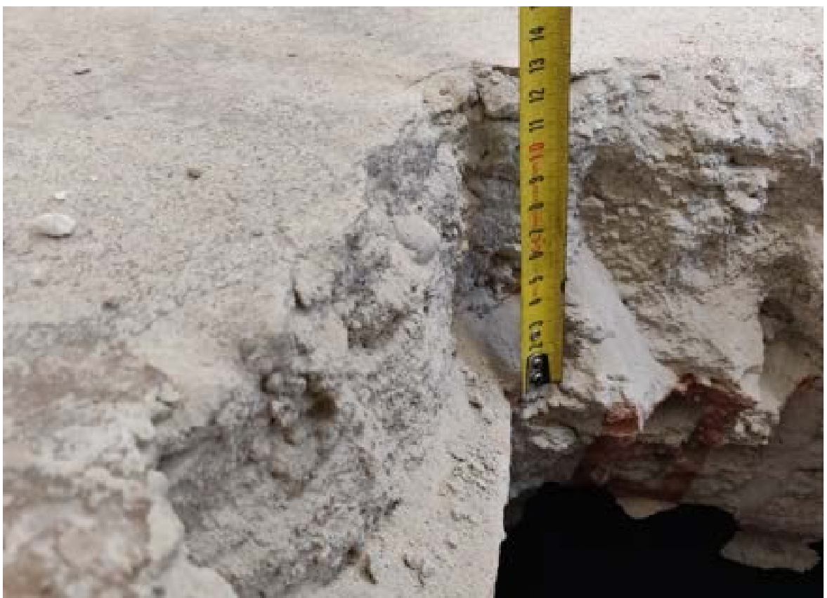
Fot. 40. Wtórny strop stalowo-ceramiczny typu Kleina z posadzką cementową w pomieszczeniu świetlicowym – podczas jego wykonywania nie zastosowano zbrojenia konstrukcyjnego
