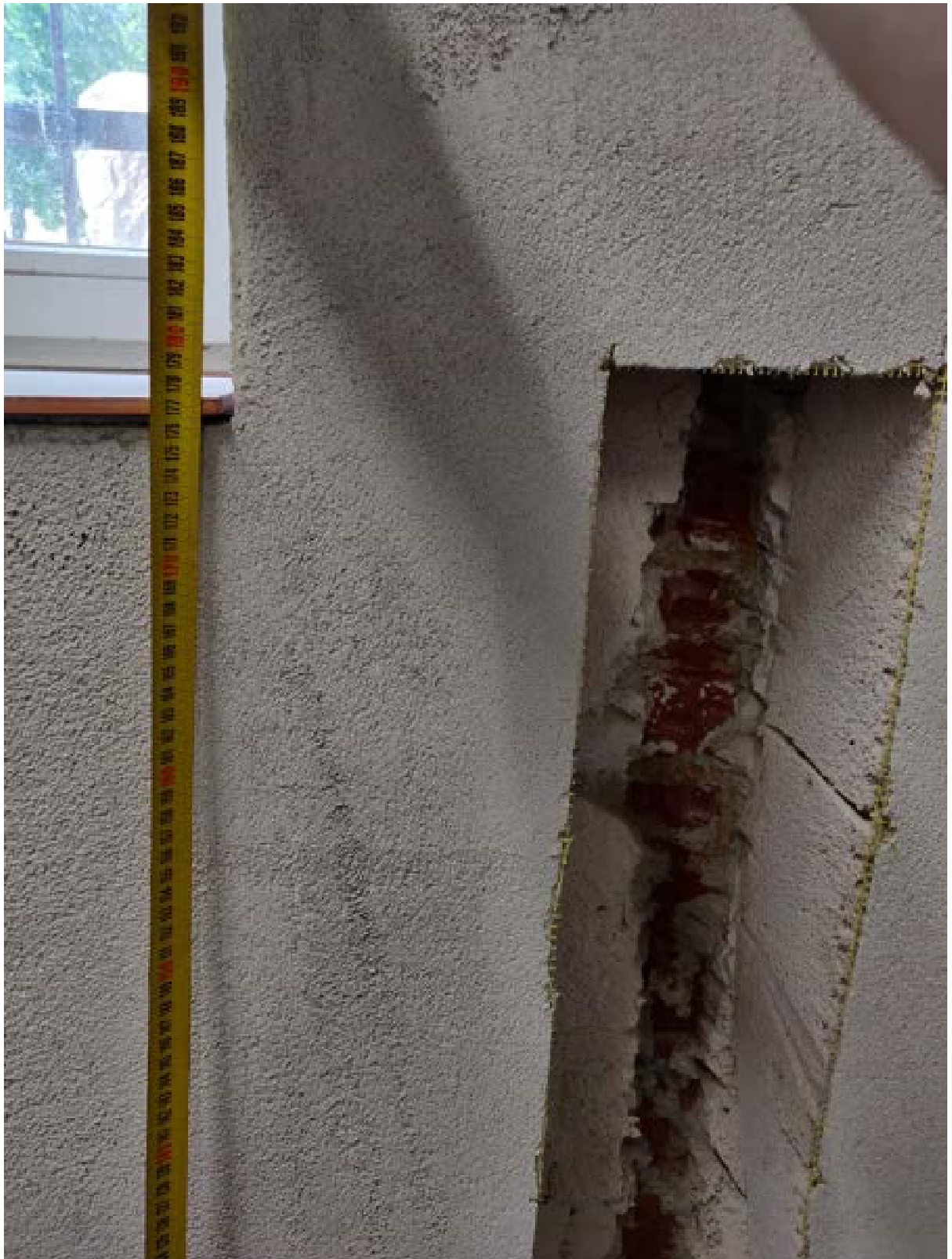
Fot. 33. Ściana zewnętrzna (zachodnia) pod spocznikiem schodów zewnętrznych, fragment widoczny od części podpiwniczonej – w miejscu odkrywki napotkano na wtórne docieplenie od wewnątrz z mineralnych płyt izolacyjnych typu Multipor, pod nim tynk zwykły i mur ceglany na zaprawie zwykłej; nie stwierdzono izolacji przeciwwilgociowych
