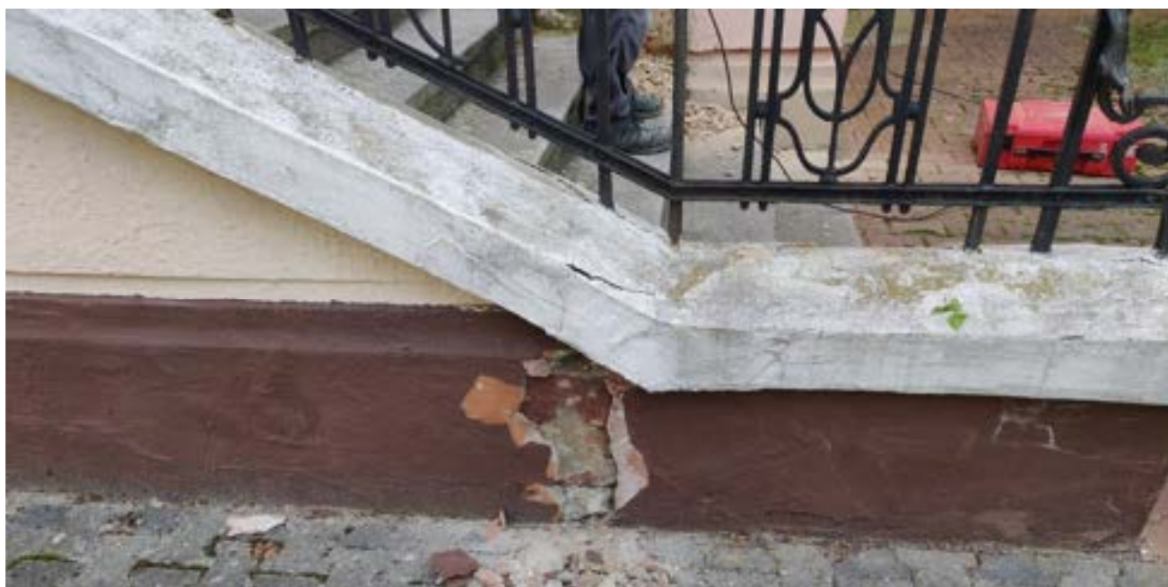
Fot. 28. Elewacja frontowa (zachodnia), fragment muru bocznego schodów wejściowych (bieg południowy) – odspojenia tynku i szlicht spadkowych wieńczących; w miejscu odkrywki napotkano na pierwotny fragment tynku cementowego cokotu
