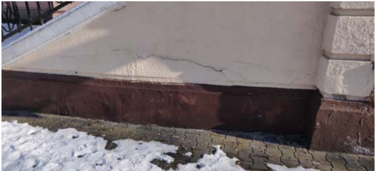
Fot. 4. Elewacja frontowa (zachodnia), fragment muru bocznego schodów wejściowych (bieg północny) – znaczne odspojenie tynku, wtórnie podklejone montażową pianą poliuretanową; mocno zawilgocona cała partia murów
