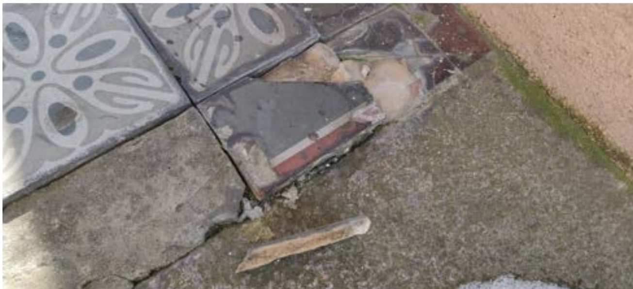
Fot. 10. Elewacja frontowa (zachodnia), spocznik schodów wejściowych – silnie zniszczone i odspojone okładziny z płytek
