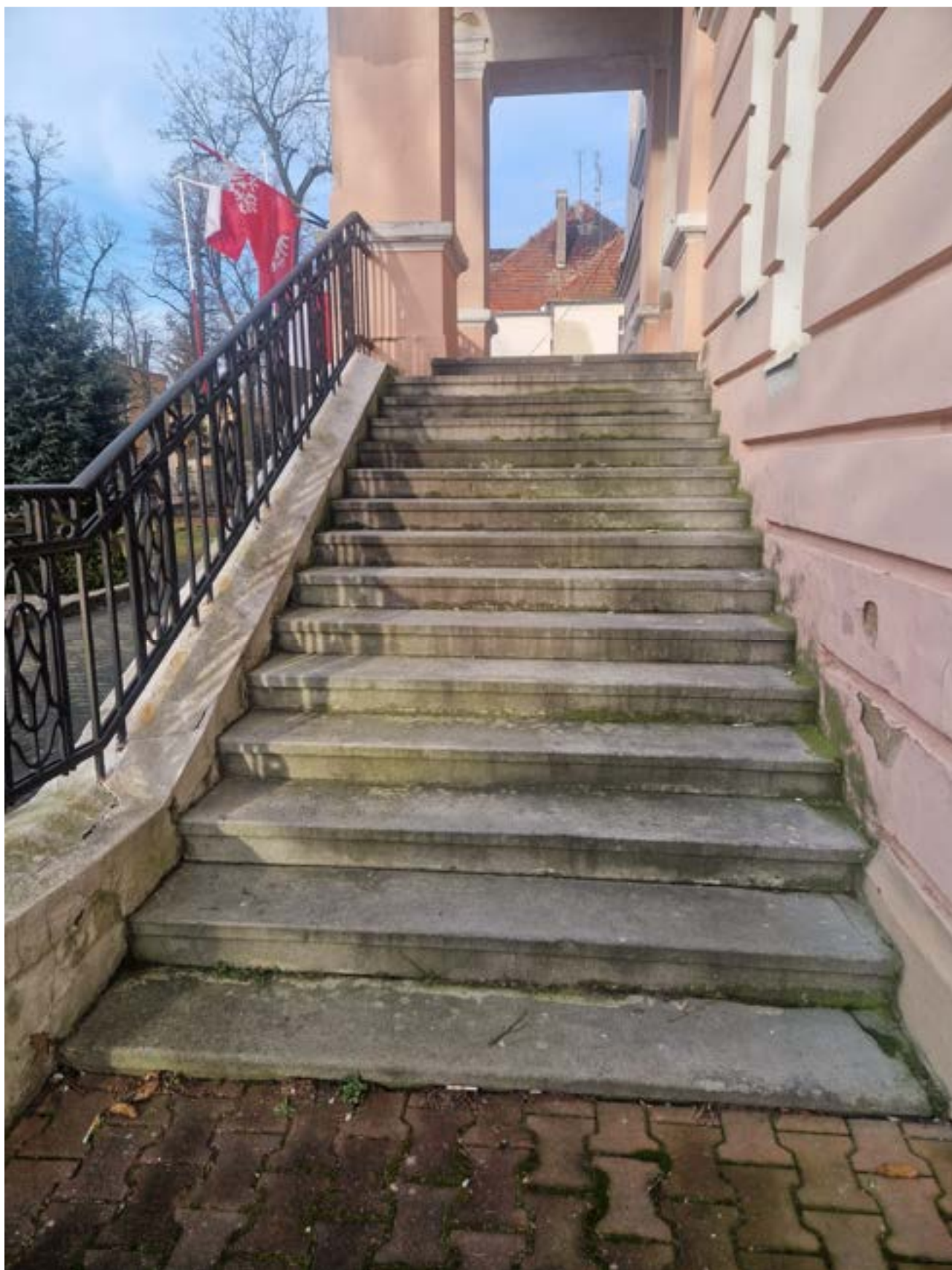
Fot. 12. Elewacja frontowa (zachodnia) ryzalitu, bieg południowy schodów wejściowych – pęknięcie dwóch stopni granitowych przy końcu osadzonym w murze ryzalitu
