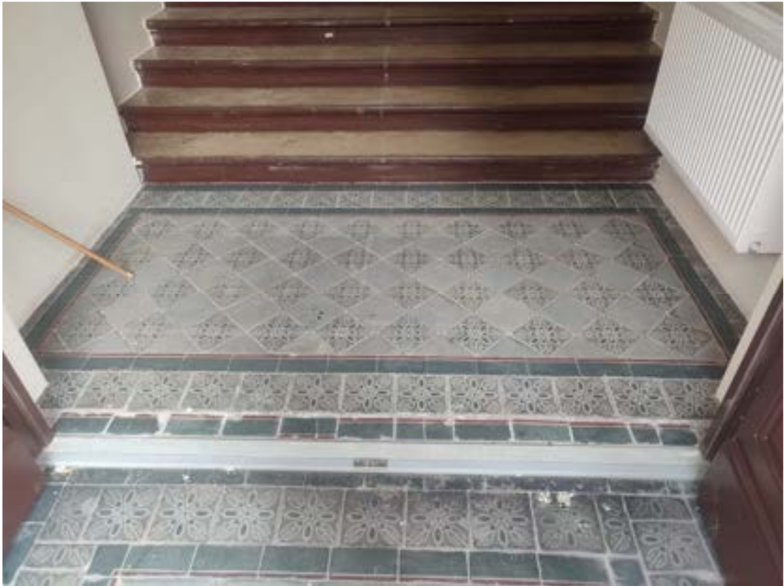
Fot. 13. Schody wejściowe wewnętrzne na parter ze spocznika zewnętrznych schodów frontowych ryzalitu – okładzina z płytek ze znacznie mniejszymi uszkodzeniami
