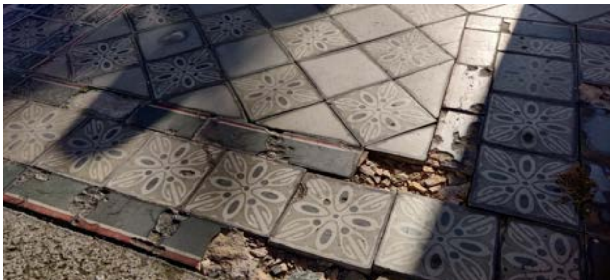
Fot. 8. Elewacja frontowa (zachodnia), spocznik schodów wejściowych – silnie zniszczone i odspojone okładziny z płytek
