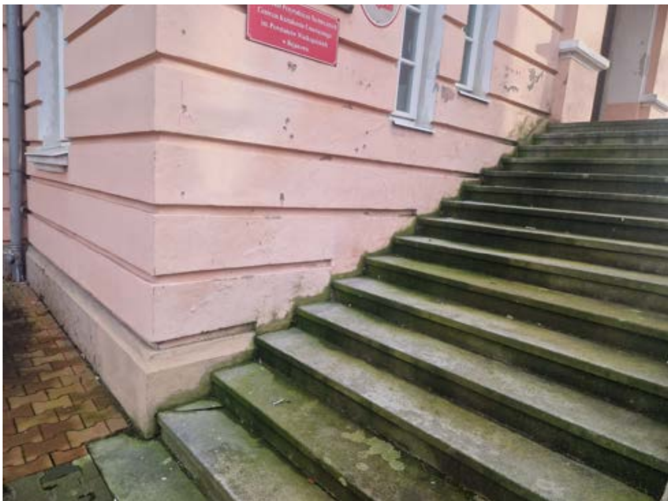
Fot. 11. Elewacja frontowa (zachodnia) ryzalitu, bieg północny schodów wejściowych – pęknięcie jednego ze stopni granitowych przy końcu osadzonym w murze ryzalitu
