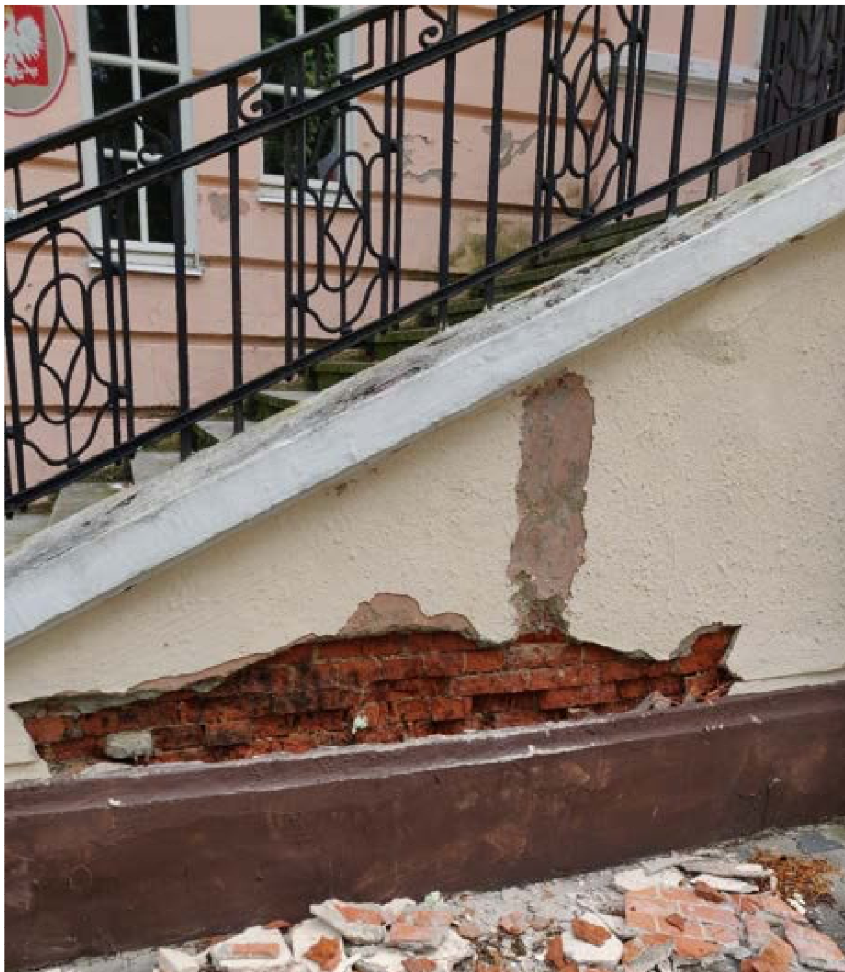
Fot. 26. Elewacja frontowa (zachodnia), fragment muru bocznego schodów wejściowych (bieg północny) – znaczne odspojenie tynku, wtórnie podklejone montażową pianą poliuretanową; mocno zawilgocona cała partia murów
