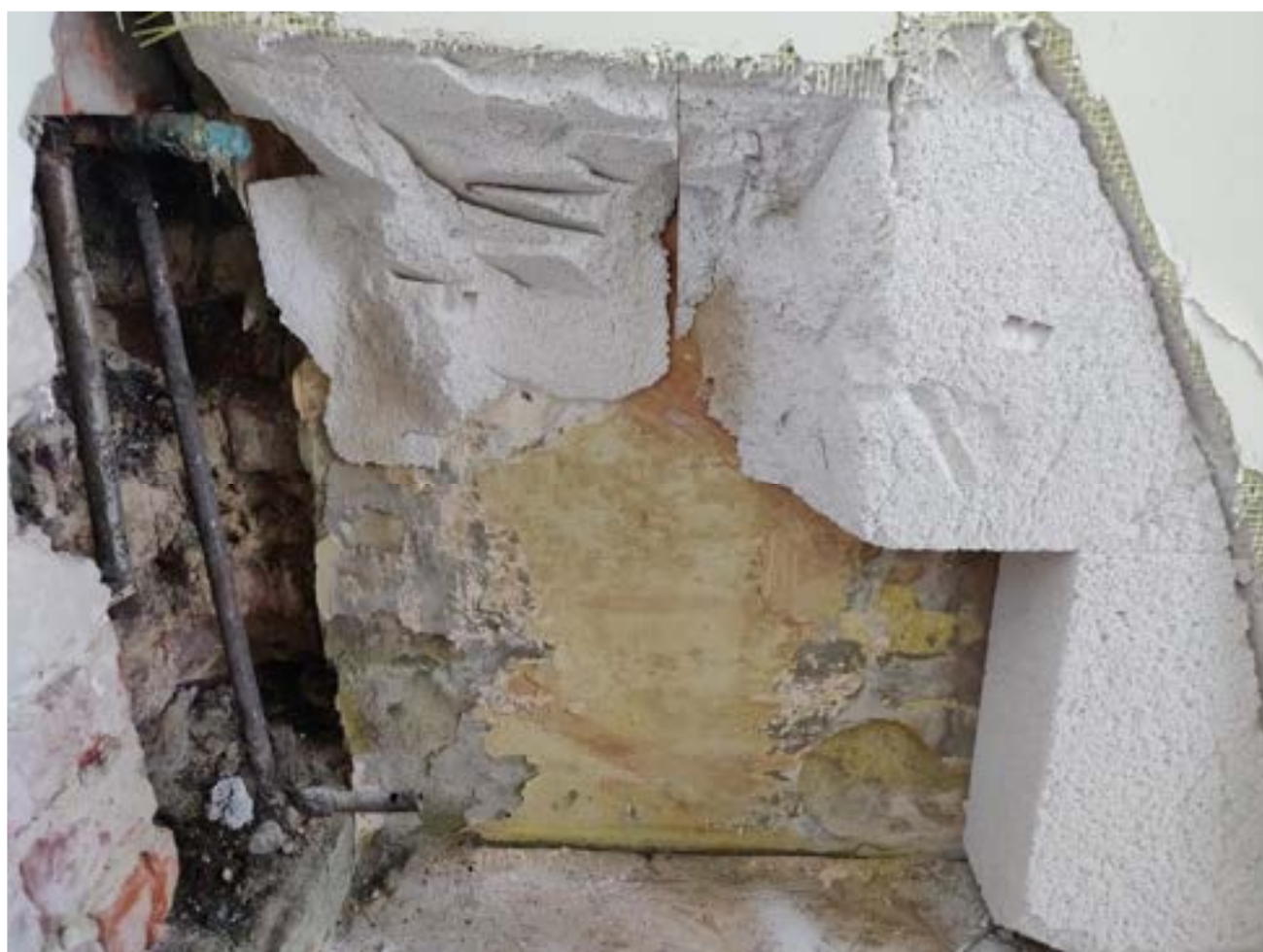
Fot. 37. Ściana zewnętrzna (zachodnia) przy schodach zewnętrznych, fragment widoczny od pomieszczenia wicedyrektor na parterze – w miejscu odkrywki napotkano na wtórne docieplenie od wewnątrz z mineralnych płyt izolacyjnych typu Multipor, pod nim tynk zwykły i mur ceglany na zaprawie zwykłej; podłoże nie gwarantuje należytej przyczepności zaprawy klejowo-szpachlowej, nie całe powierzchnie płyt mają kontakt z podłożem, zastosowano zaprawy gipsowe oraz nieparoprzepuszczalne powłoki malarskie
