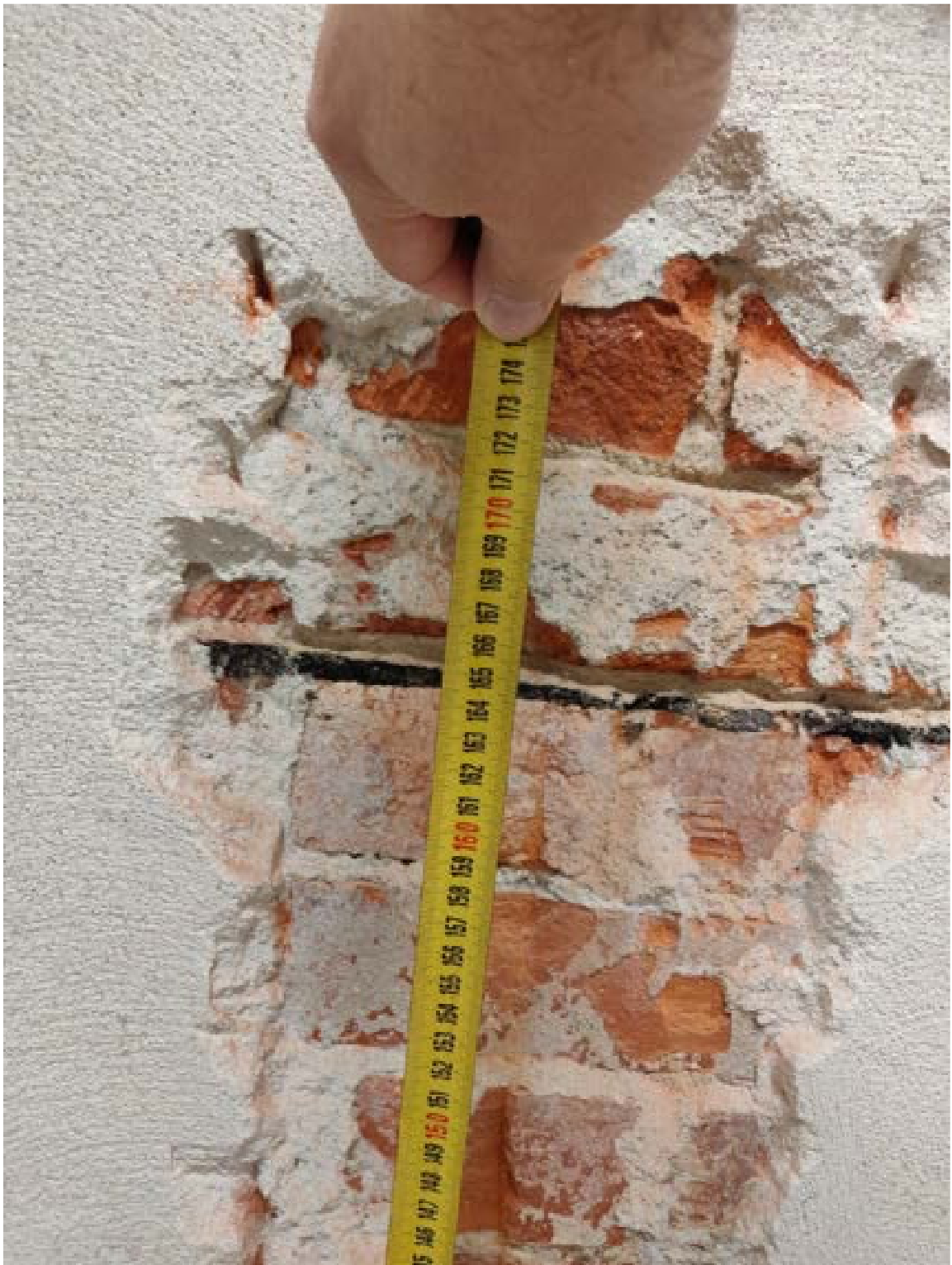
Fot. 34. Ściana wewnętrzna między częścią podpiwniczoną a помещением wicedyrektor na parterze, fragment widoczny od części podpiwniczonej – pod tynkiem (niepotrzebnie wykonany, bo ograniczającym odparowanie wilgoci oraz niepoprawnie, bo bez rozcięcia w poziomie izolacji) w murze ceglany zinventaryzowano poziomą izolację przeciwwilgociową bitumiczną
