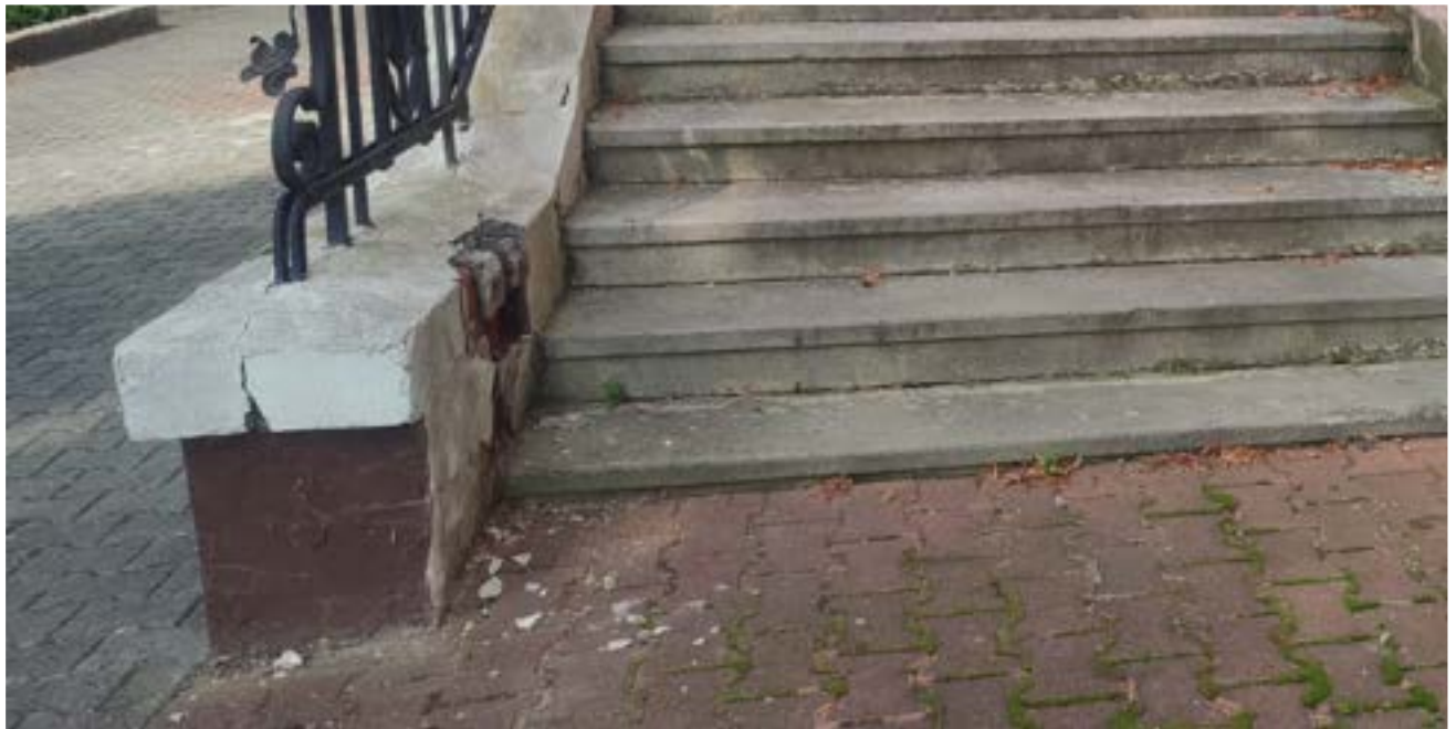
Fot. 6. Elewacja frontowa (zachodnia), fragment muru bocznego schodów wejściowych (bieg południowy) – znaczne odspojenie tynków, szlichty spadkowej oraz cegieł; mocno zawilgocona cała partia muru
