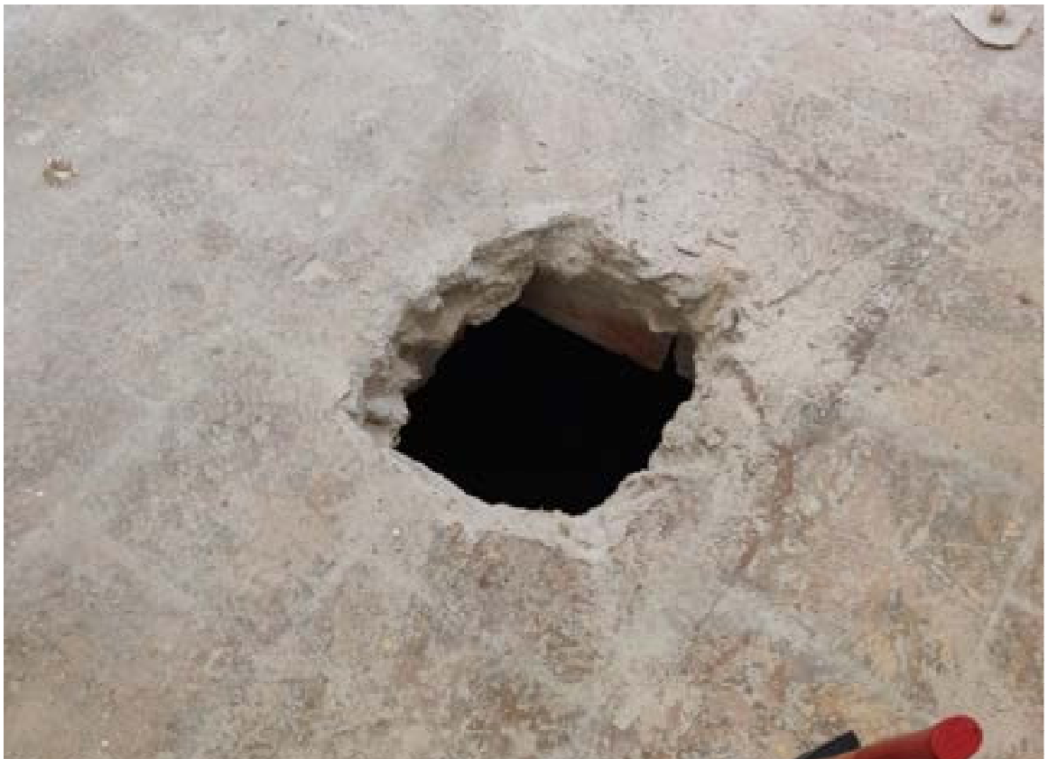
Fot. 39. Wtórny strop stalowo-ceramiczny typu Kleina z posadzką cementową w pomieszczeniu świetlicowym – podczas jego wykonywania nie zastosowano zbrojenia konstrukcyjnego
