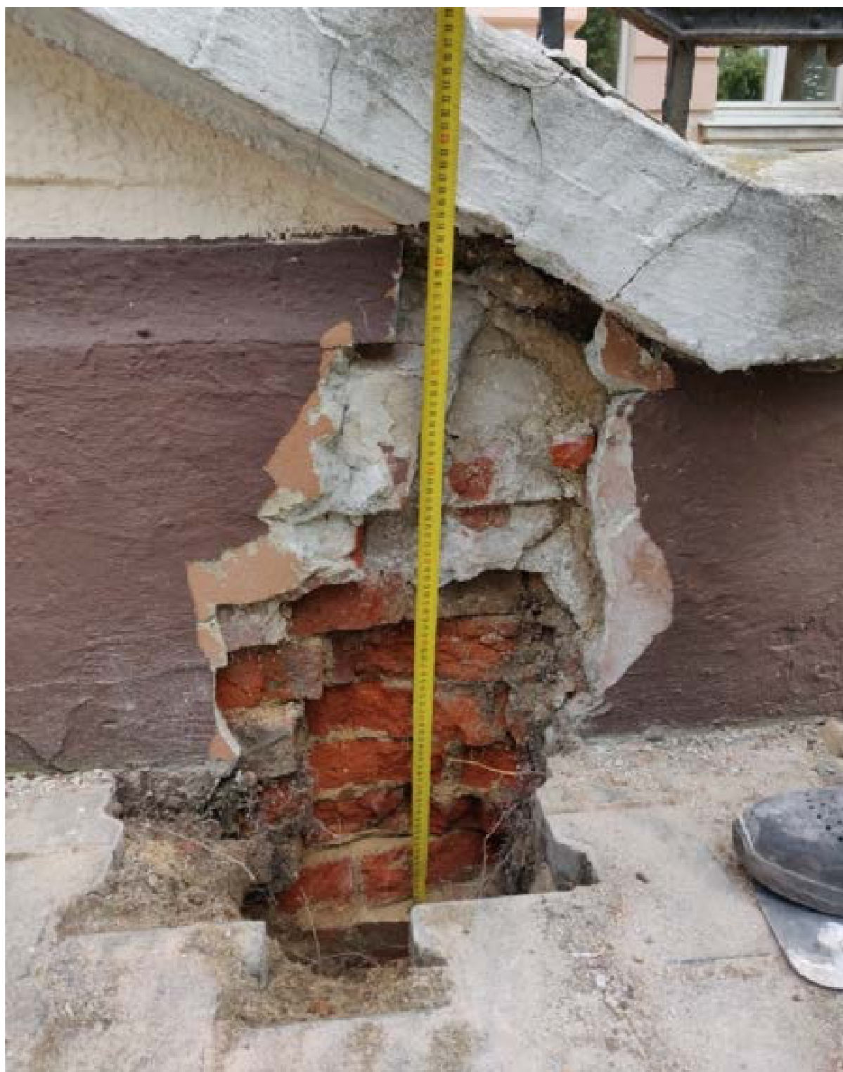
Fot. 30. Elewacja frontowa (zachodnia), fragment muru bocznego schodów wejściowych (bieg południowy) – w miejscu odkrywki tynku napotkano na pierwotny fragment tynku cementowego cokołu, a przy wykopie natrafiono na odsadzkę ceglana; brak izolacji przeciwwilgociowych
