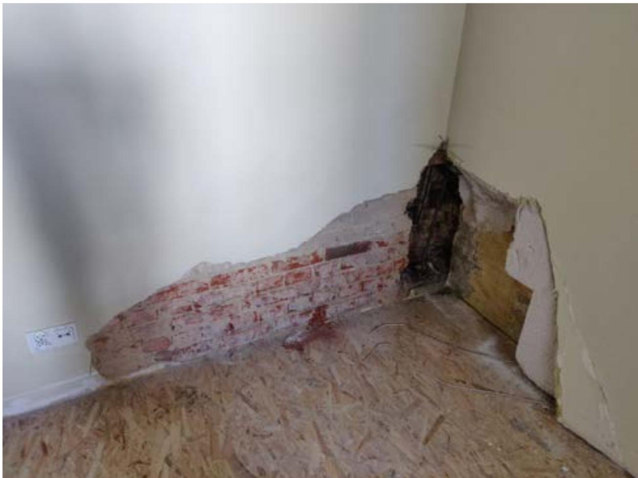
Fot. 38. Ściana wewnętrzna między pomieszczeniem wicedyrektor na parterze a częścią podpiwniczoną – w miejscu odkrywki napotkano na miejscami odspojone tynki oraz pozostawione w bruzdach/szachtach nieużytkowane i niezaizolowane instalacje, które mogą być przyczyną m.in. kondensacji pary wodnej
