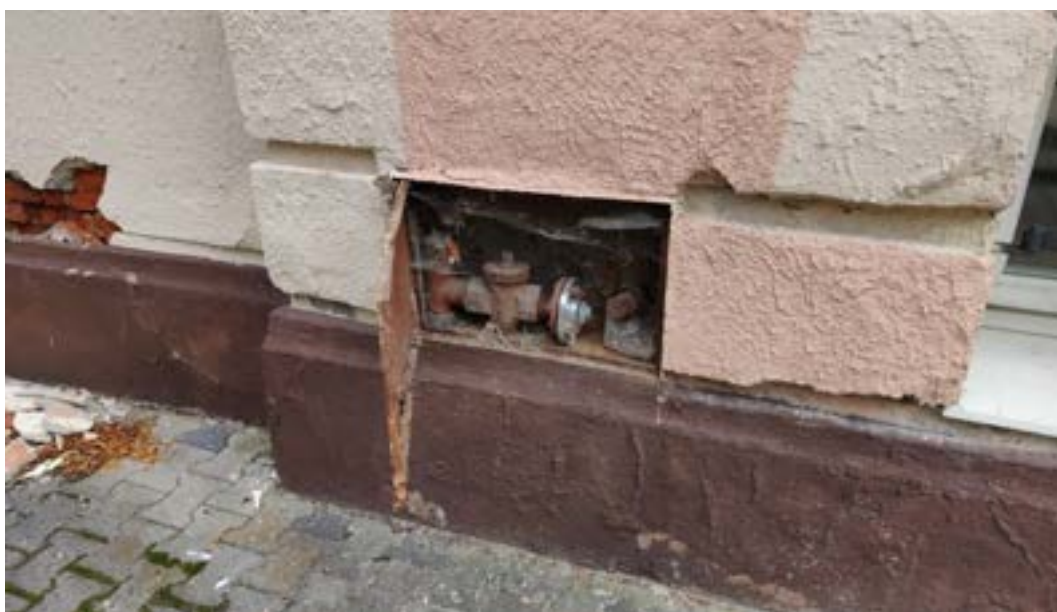
Fot. 32. Skrzynka gazowa na przyłączy z zaworem gazowym, z obecnie niewykorzystywaną i nieużytkowaną w budynku instalacją
