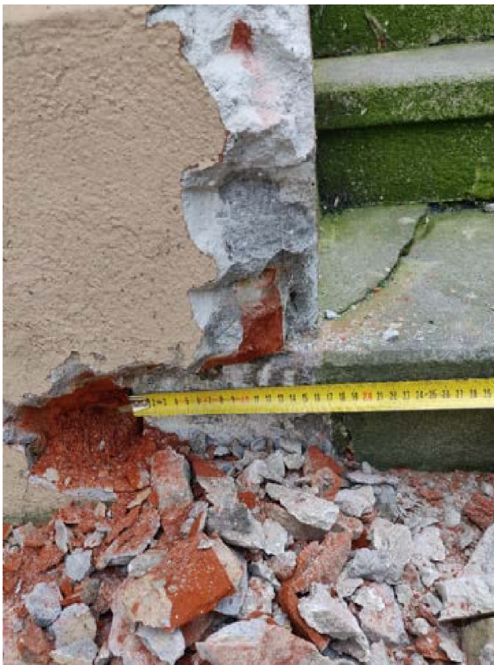
Fot. 22. Sposób osadzenia stopni granitowych w murze ryzalitu – na sztywno, na mocnej zaprawie cementowej
