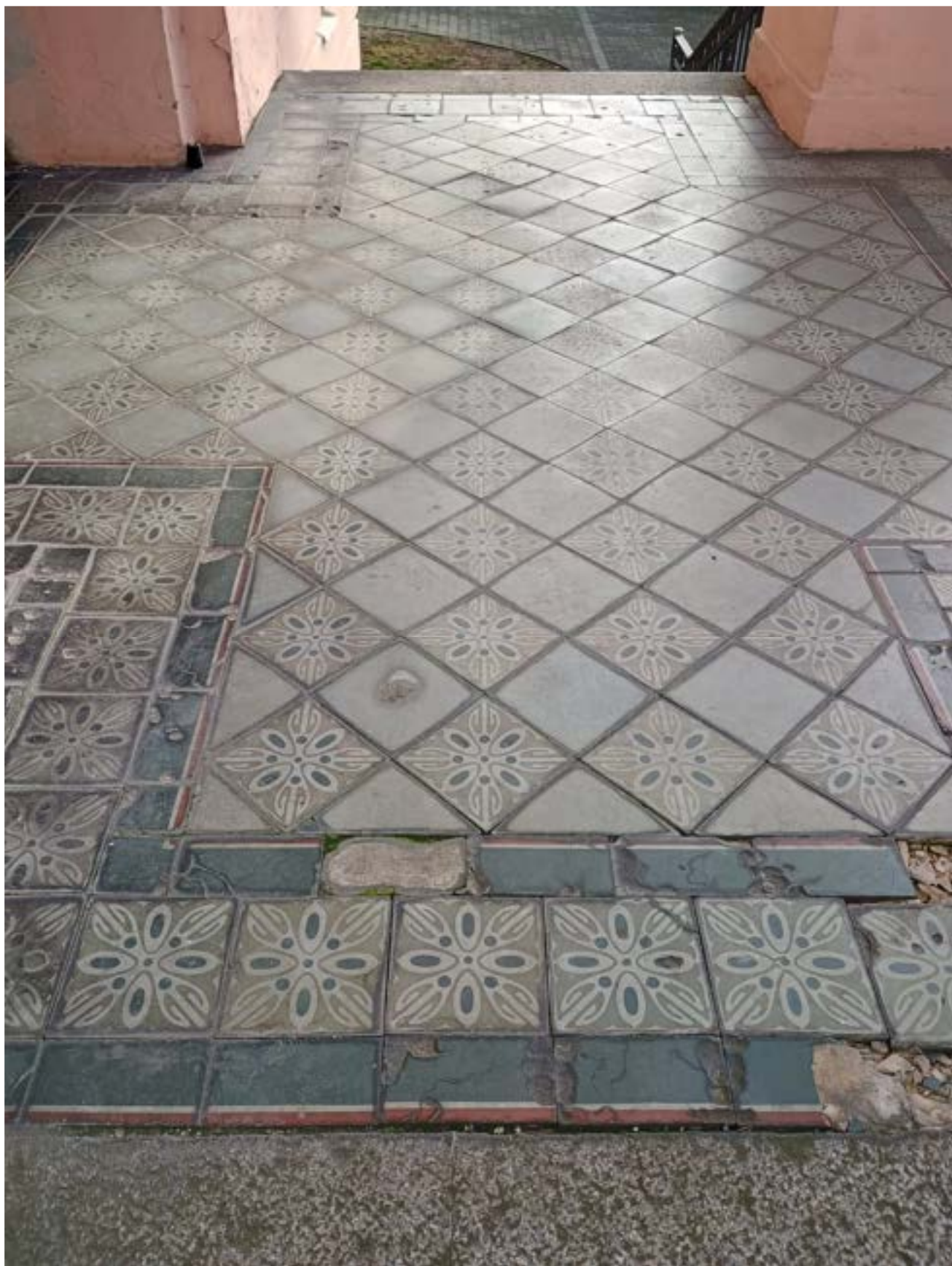
Fot. 7. Elewacja frontowa (zachodnia), fragment ryzalitu ze schodami wejściowymi – spocznik schodów z silnie zniszczonymi i odspojonymi okładzinami z płytek
