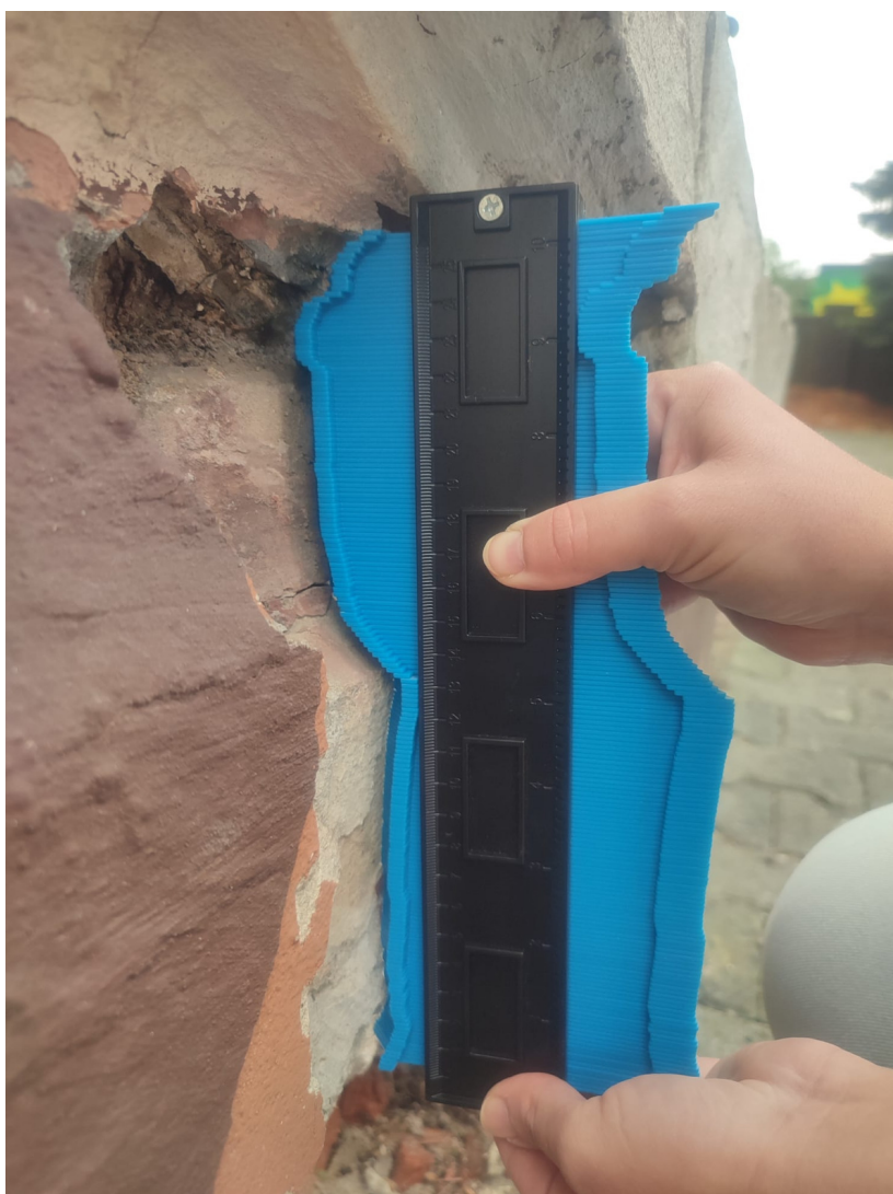
Fot. 2. Profilowanie pierwotnego cokołu murków bocznych schodów zewnętrznych, które należy odtworzyć wg szablonu do zinwentaryzowania na etapie prac
