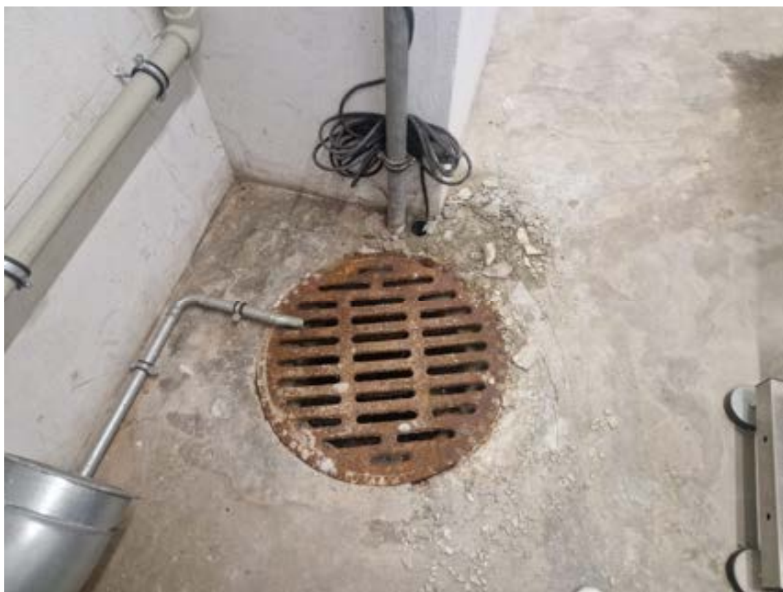
Fot. 18. Pomieszczenie w podpiwniczeniu pod frontowymi schodami wejściowymi (od strony południowej) – silne zawilgocenia i odspojenia posadzki
