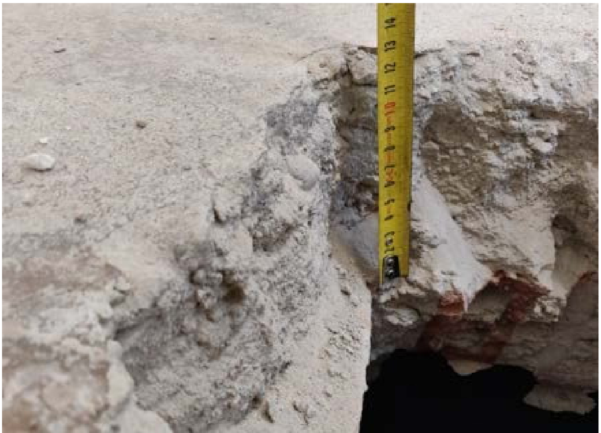
Fot. 40. Wtórny strop stalowo-ceramiczny typu Kleina z posadzką cementową w pomieszczeniu świetlicowym – podczas jego wykonywania nie zastosowano zbrojenia konstrukcyjnego
