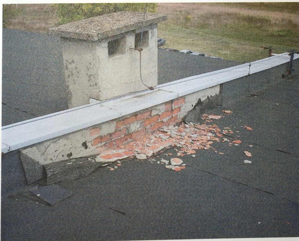
Zdj. nr2. Widoczne uszkodzenia izolacji przeciwwilgociowej wywiniętej na ogniomur
